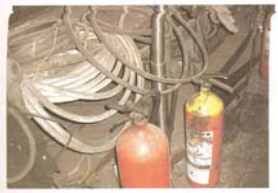
這裡的物件還要用嗎?如不使用,應註銷,如仍須使用,要設置整齊。
