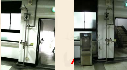
沖淋設備旁設置插座、飲水機及電源線
