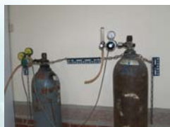
氣體鋼瓶未固定妥當，易因地震或其他因素造成傾倒、滾動，引發危害。
